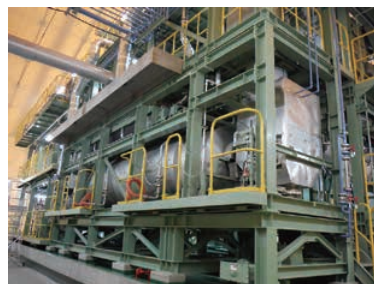
福島市・堀河町下水処理場における放射性汚泥の減容化プロジェクト
